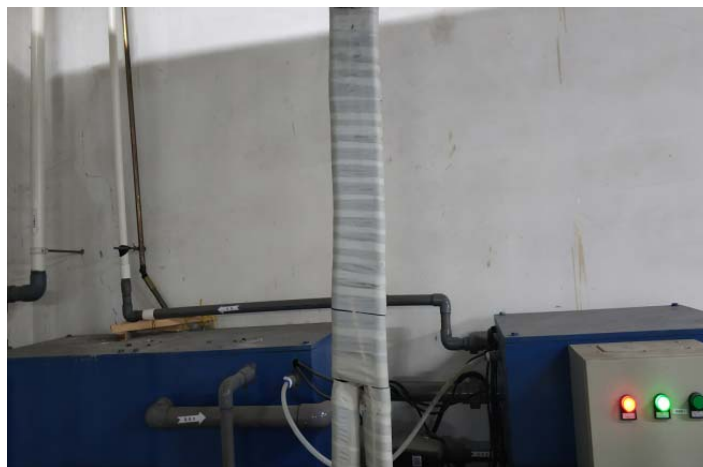
图4.1-2 污水处理设备
